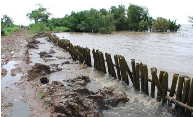
Hình 9. Xói lở bờ biển
